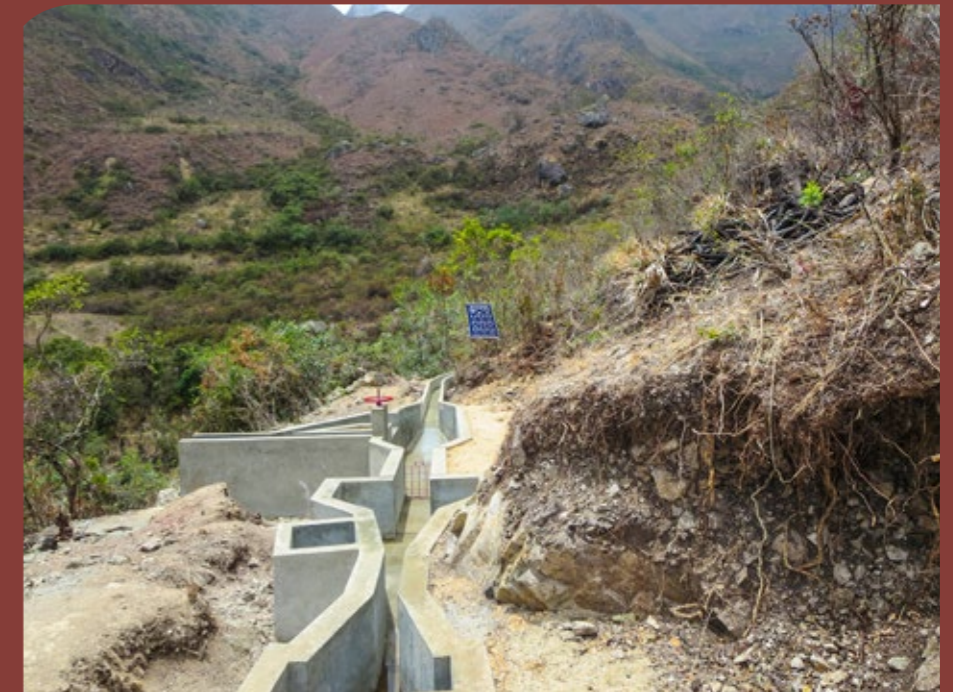
▲ Infraestructura de Riego Chuquitambo – Carrizales. Desarenador y medidor Parshall.
